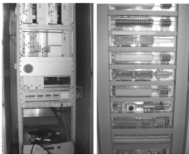
图 14 VST 望远镜控制机柜 Fig. 14 Control cabinet of VST
